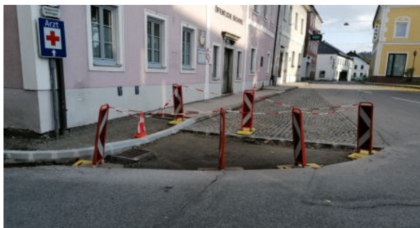
Die abgeflachte Gehsteigkante muss noch asphaltiert werden.
