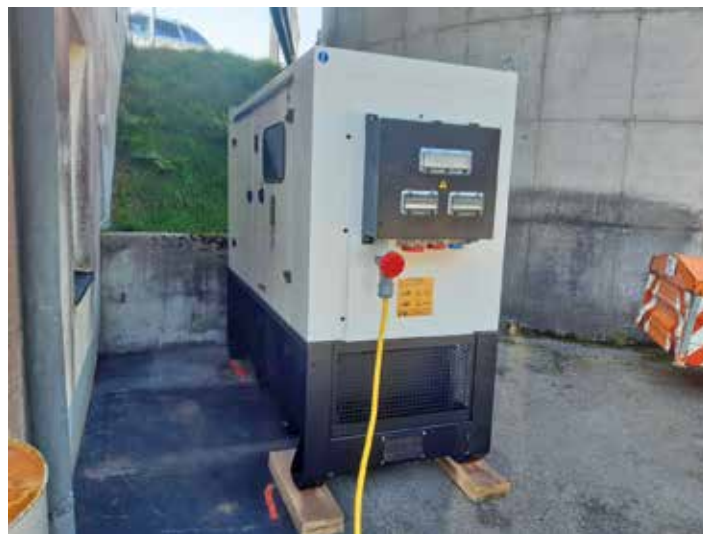
Das neu angekaufte stationäre Notstromaggregat soll die Einsatzfähigkeit der Kläranlage im Ernstfall sicherstellen.
