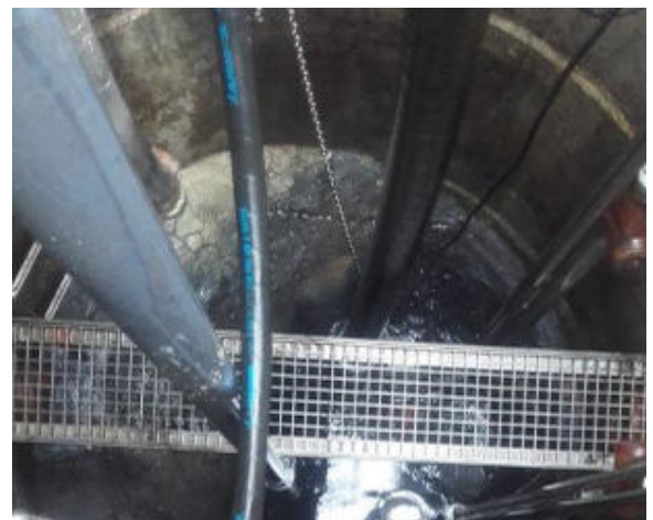
Blick in das Innere eines Pumpenschachtes.
