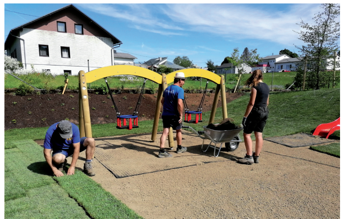
Die Gemeindearbeiter aller 4 Gemeinden gestalteten gemeinsam mit der Firma Garten Verde den tollen Außenbereich der neuen Krabbelstube.
