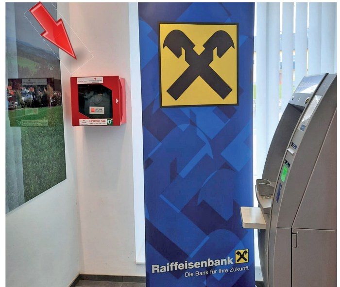
Defibrillator in der SB-Zone der Raiffeisenbank am Marktplatz
