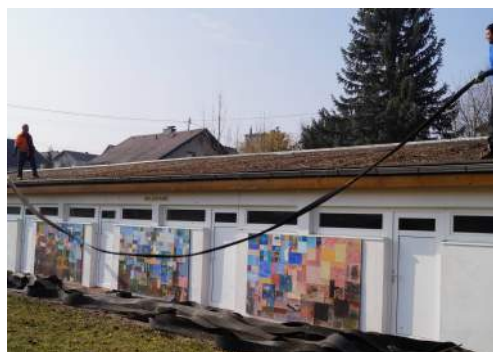
Die porös gewordenen Schläuche der Solaranlage auf dem Kabinentrakt wurden von den Gemeindearbeitern abgebaut. Die erneuerte Solaranlage samt vorgeschriebenem Wärmetauscher sollte dann doch wieder 25 Jahre ihre Dienste tun.
